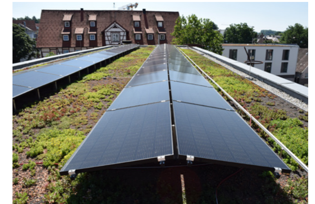
Abb. 17: Ein Beispiel für ein Solargründach mit Ost-West-Ausrichtung in „Sattelbauweise“. Quelle: BuGG
